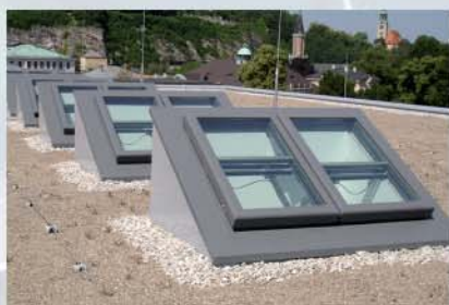
Montado sobre zócalo inclinado
