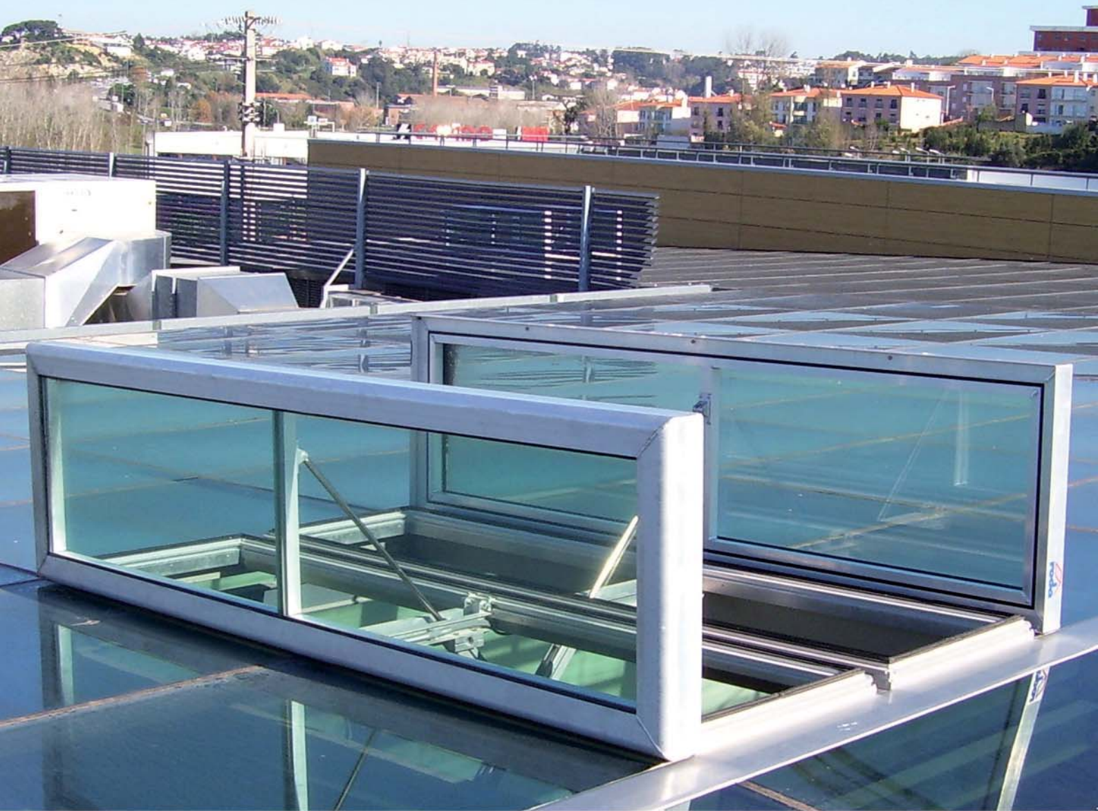
Ilustración grande: exutorios tipo FIREFIGHTER instalados en la cristalera de un atrio.
