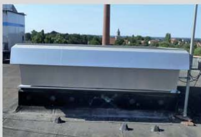
Ventilación natural incluso con lluvia
