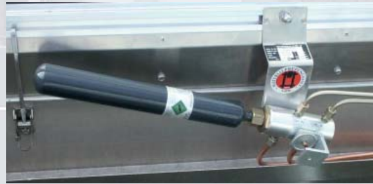
válvula de prioridad con activación por temperatura conectada a un cartucho de CO 2
