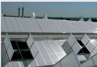
PHOENIX de doble compuerta sobre DELTALIGHT.
