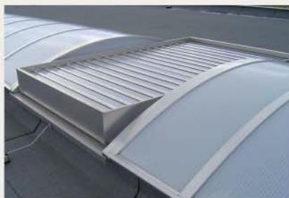
Instalado en lucernario
